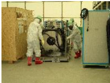
堆積物除去装置 (高圧水、AWJ) 設置
