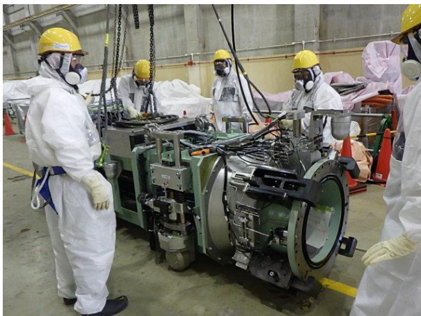
堆積物除去装置 (低圧水) 外観
