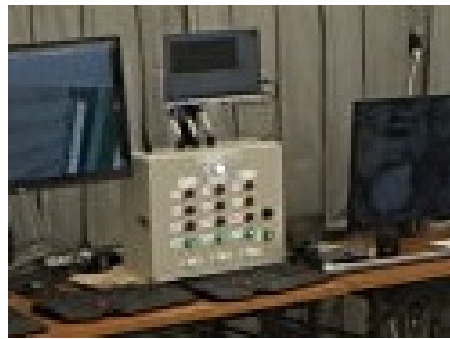
ダスト濃度グラフ表示用液晶モニタ (上) と警報盤 (下)
