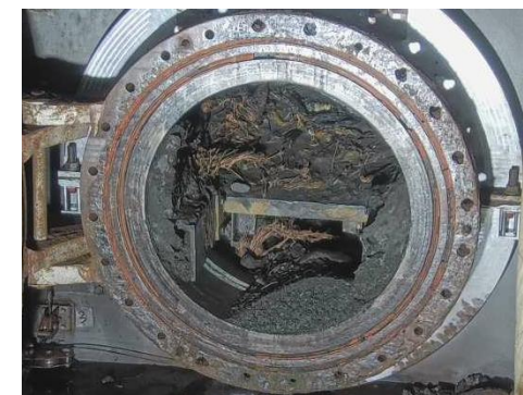
X-6ペネトレーション内面の 堆積物残留状態
