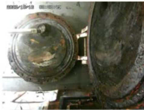
90度ハッチ開放完了
