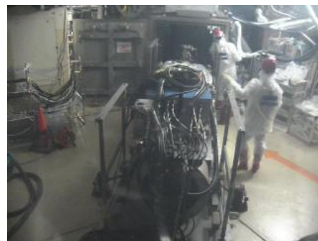
装置作動用の ケーブル・ホースの結線
