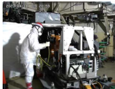
ハッチ開放装置ケーブル接続
