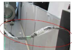
内側敷設ケーブル（灰色テープ）
