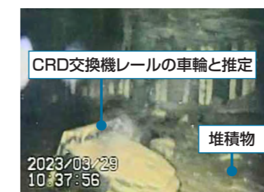
ペDESTAL内底部の状況2
