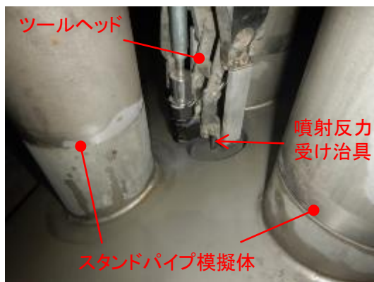
シュラウドヘッド切断後の状況
